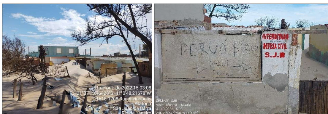
Figura 18 – Residências em ruínas devido ao avanço do mar em Atafona, São João da Barra, RJ.
